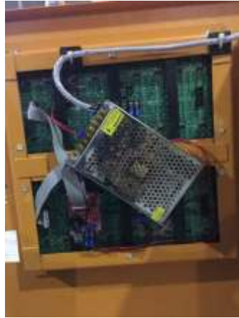
کنترل بخش اینورتر
